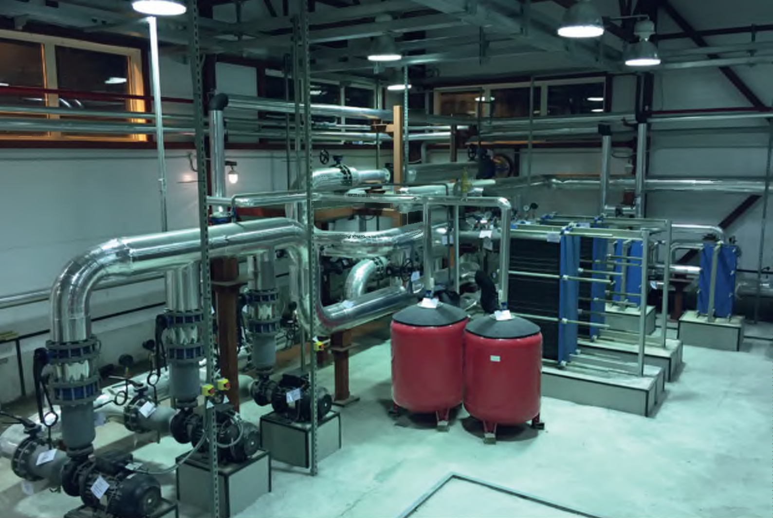
Котельная, г. Апатиты
